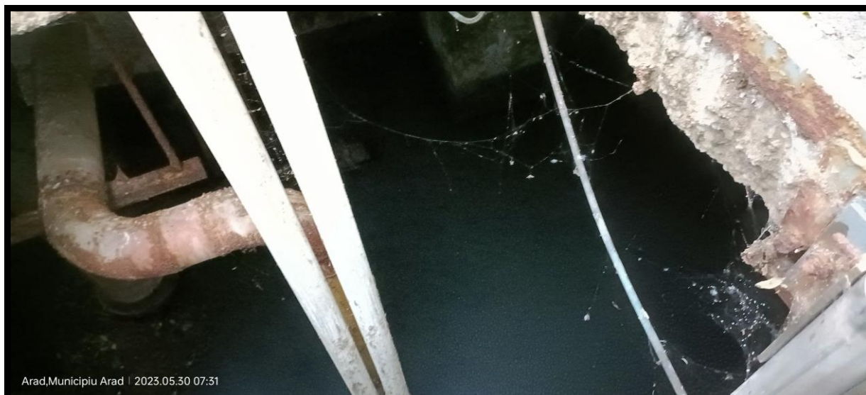
Foto 3 – Armatura fara strat de acoperire
