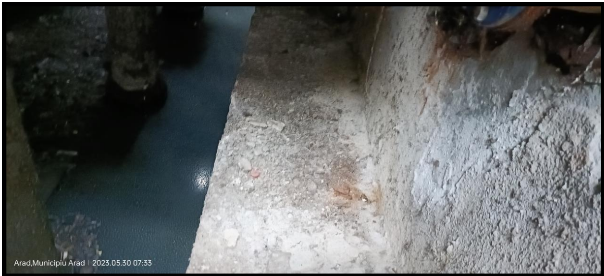
Foto 1 – Beton cu aspect friabil și/sau zone din beton exfoliat
