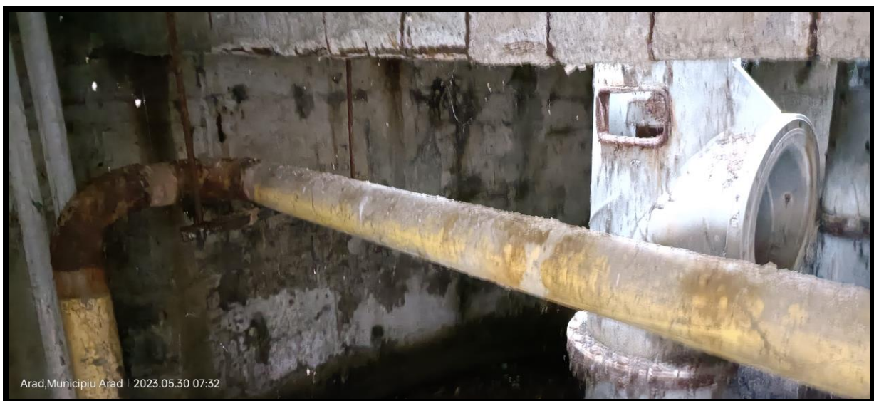
Foto 2 – Defecte de suprafață ale feței văzute (culoare neuniformă, pete negre, impurități, pete de rugină, aspect prăfuit, imperfecțiuni geometrice, aspect macroporos);
