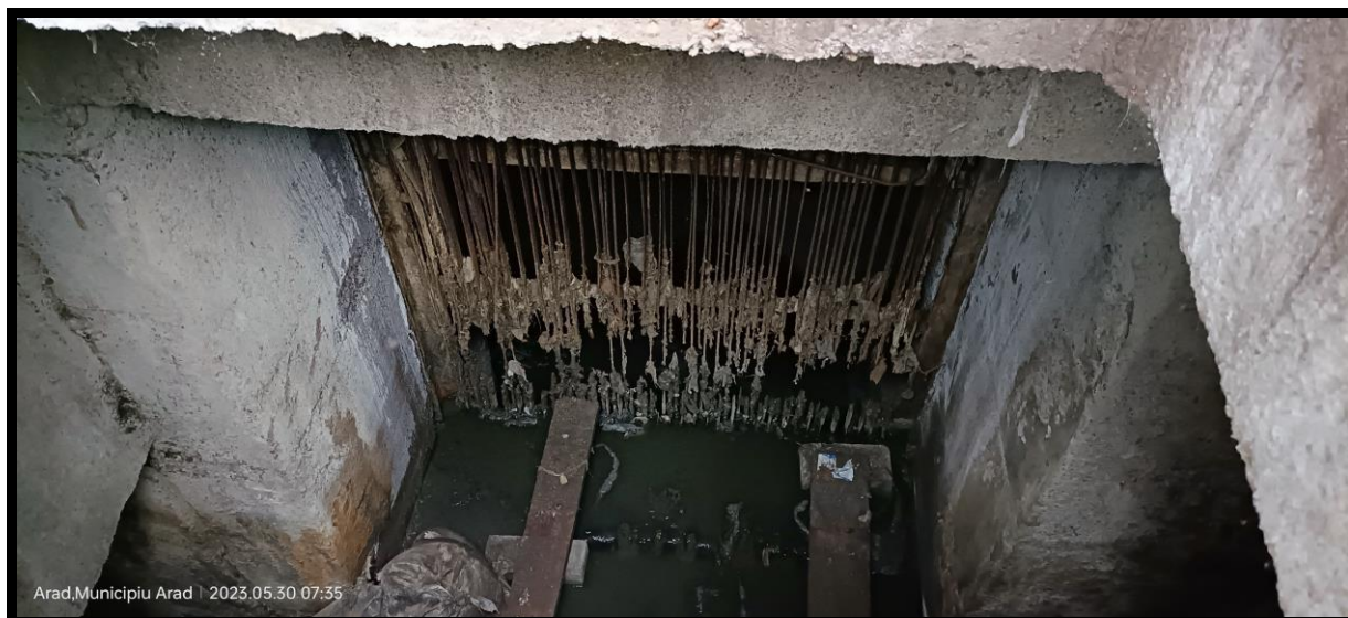
Foto 7 – Corodarea gratarelor metalice
