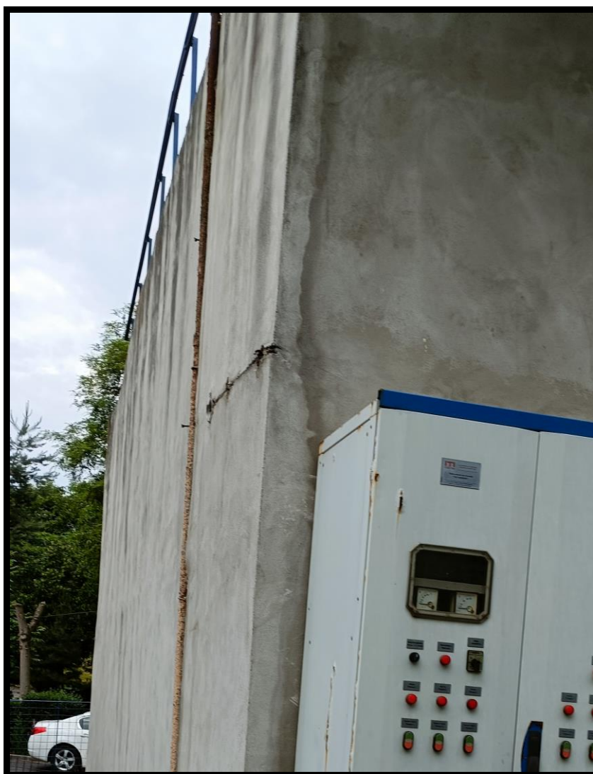
Foto 8 – Lisa aticurilor și a lăcrimarilor la partea superioară a camerei stăvilarelor
