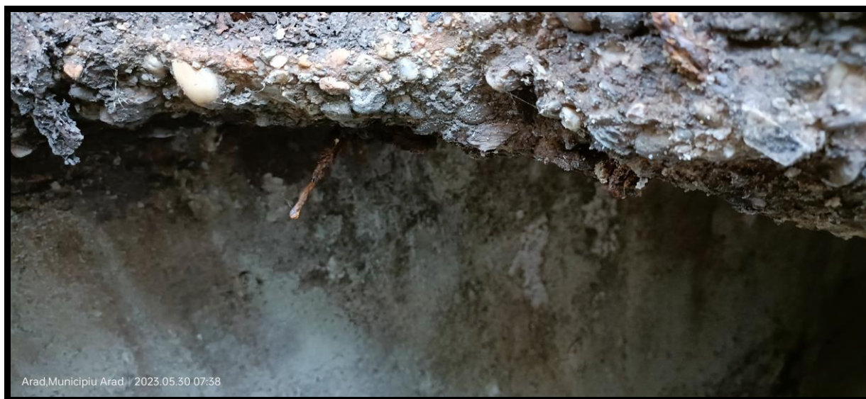
Foto 4 – Elemente din beton cu secțiune redusă
